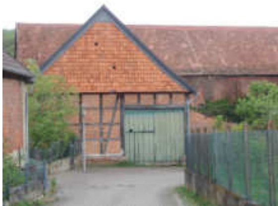
Sanierungsbedürftiges Tor, Beispiel aus Steinlah
