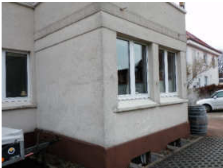
Negativbeispiel: Überdimensionierte Kunststofffenster mit nicht zeitgemäßer Dämmung
