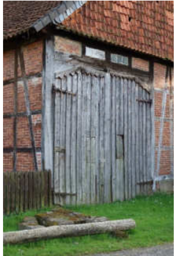
Dominantes, ortsbildprägendes sanierungsbedürftiges Scheunentor aus Gustedt
