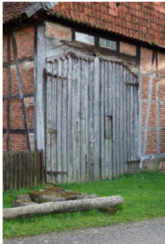
Ebenfalls erhalten aber dringend sanierungsbedürftig, Beispiel aus Gustedt
