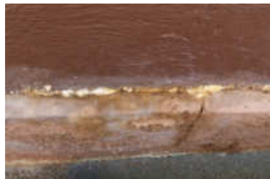
Schadensbild: Kaschierung mit Bauschaum und falscher Farbe – Ergebnis: Pilsbefall
