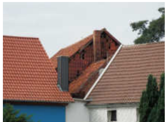
Negativbeispiel: Schornsteineinfassung (links)
