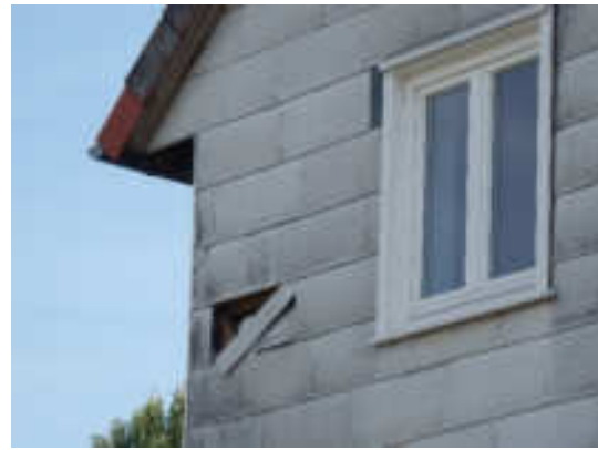
Negativbeispiel: Asbesthaltiger Plattenbehang
