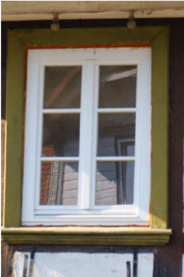
Negativbeispiel: Mit Bauschaum eingefasstes Kunststofffenster
